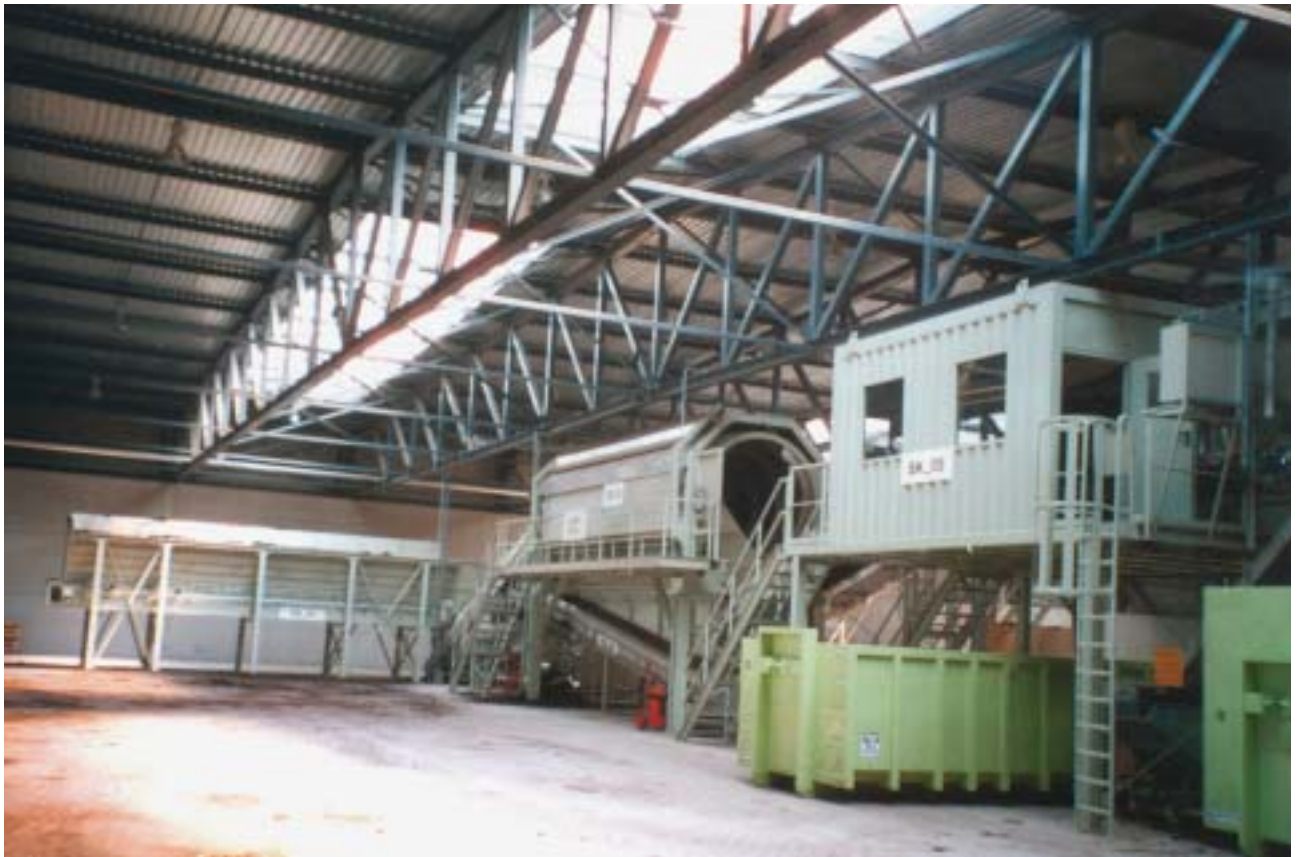
Siebanlage für Kompost mit Nachsortierung
